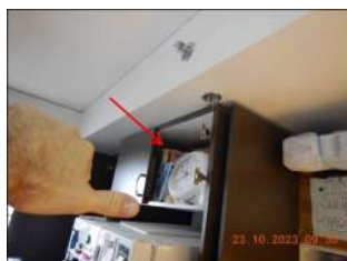
Porte armoire manquante. A installer
