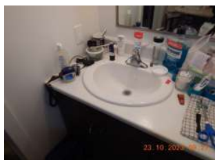
Remplacer le scellant autour du lavabo et/ou de la vanité – Risque infiltration d'eau entre le lavabo et le comptoir et/ou la vanité.
